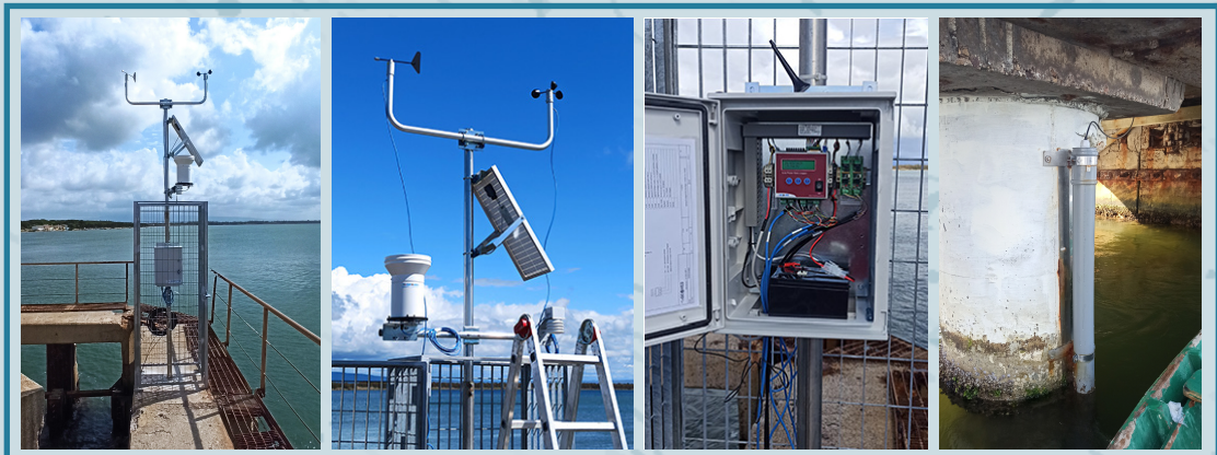
Stazione meteo sul ponte Dettaglio sensori meteo Data logger stazione meteo Idrometro piezometrico in un pilone del ponte
